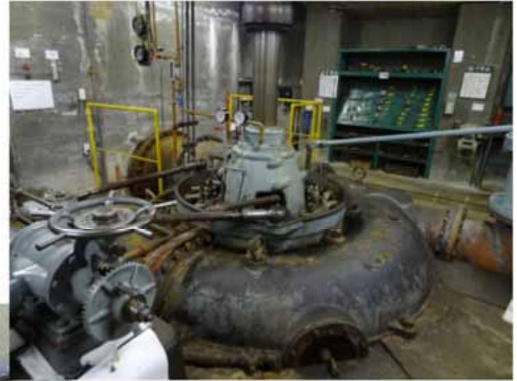
旧水車発電機 1936年稼働
