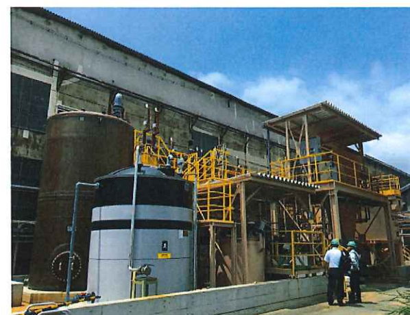
廃水処理設備
