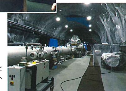
KAGRA内部 超高真空ダクトと クライオスタット
