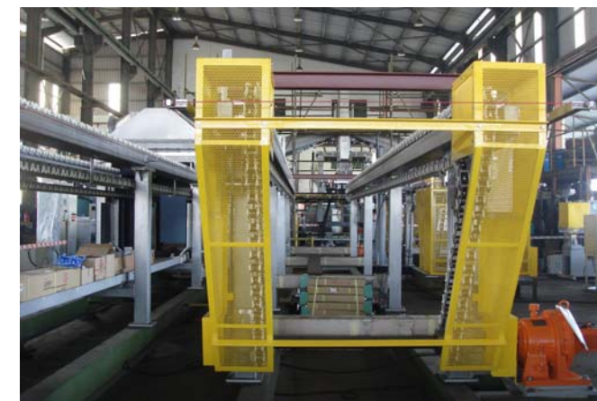
剥取機（カソード排出コンベア）
