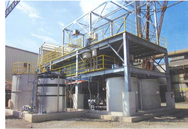
フィルタープレス設備
