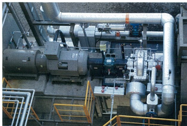
蒸気タービン設備
