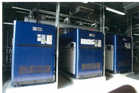
蒸気発電機設備（3基）
