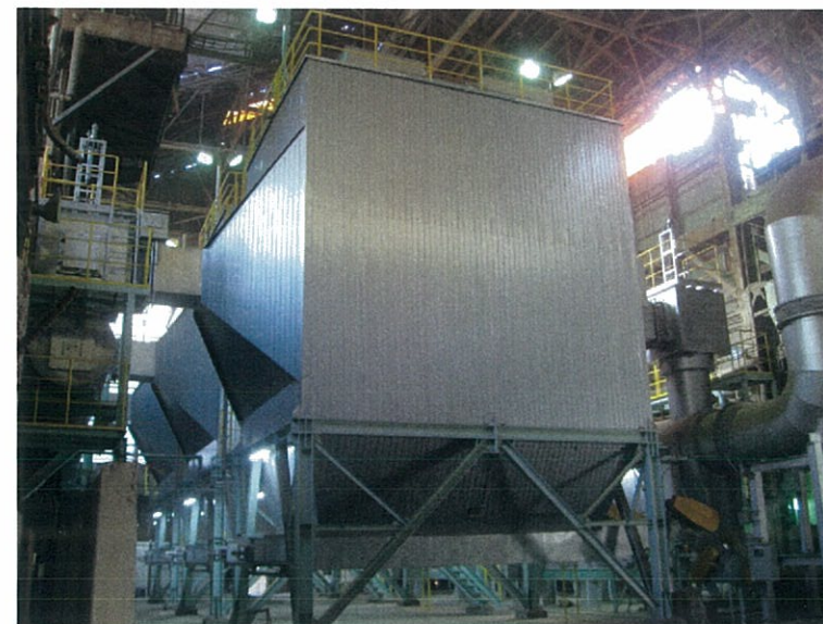
電気集塵機全景
