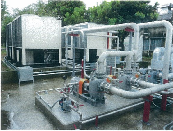
冷却水温度コントロール制御装置
