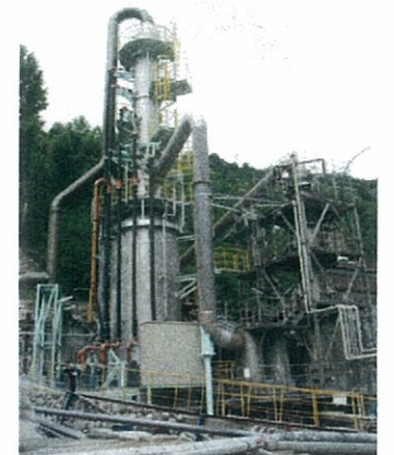
新脱硫塔設備
