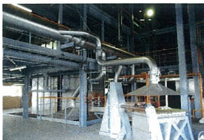
リボイラー設備
