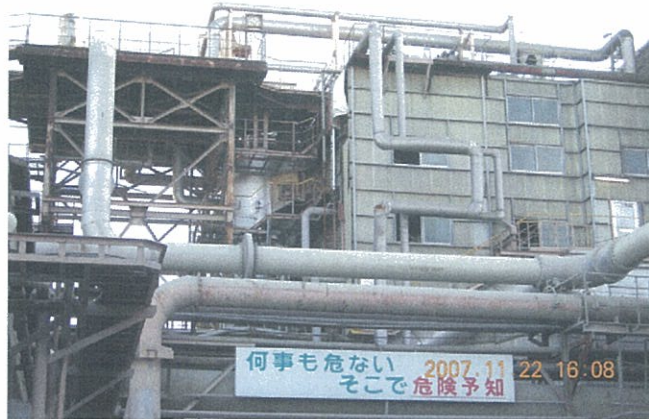
三池MF 炉廃熱ボイラ
