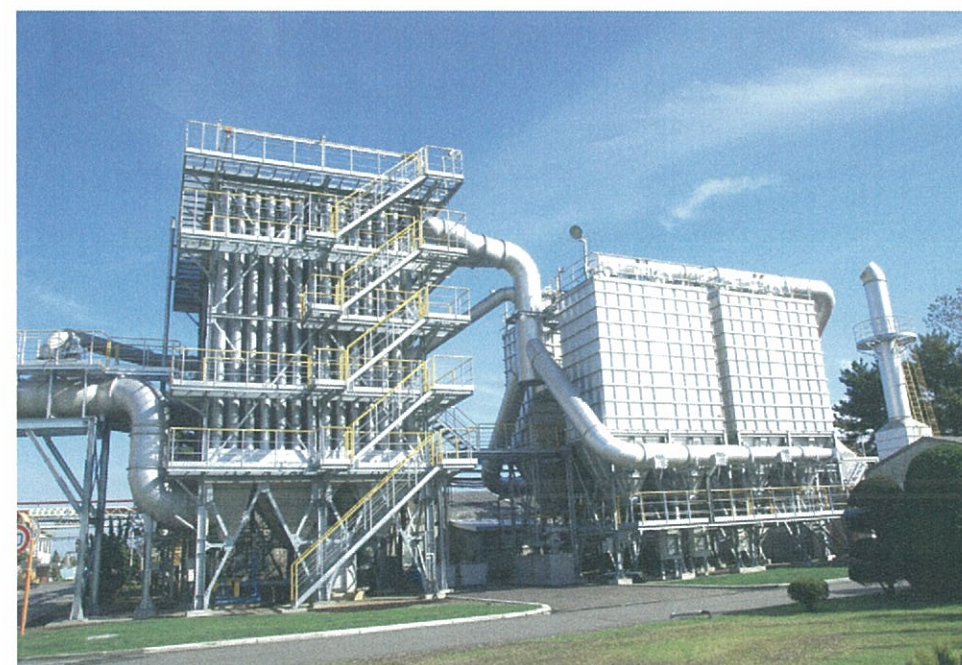
亜鉛精製工場排ガス処理設備
