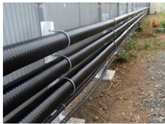
三井金属触媒事業部プラント配管 GNGWA-13.6 W75・W50
