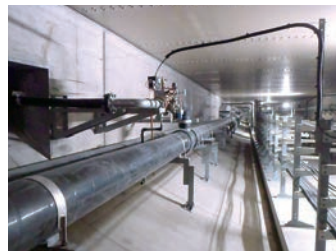
中央環状川線トンネル消火設備配管 WEET-AP W250・W200
