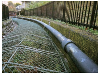
奥多摩町下水露出配管 WE-13.6 W150
