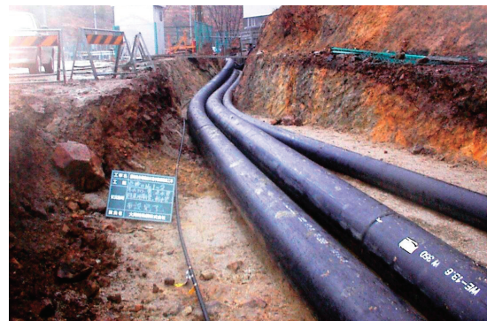
●最終処分場の浸出水送水配管●
