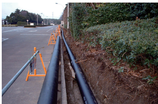
●工業用配水管●
