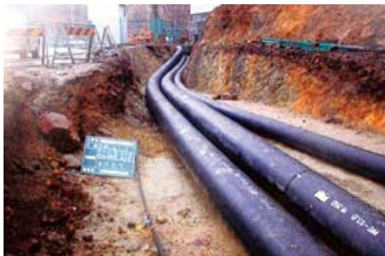
●最終処分場の浸出水送水配管●
