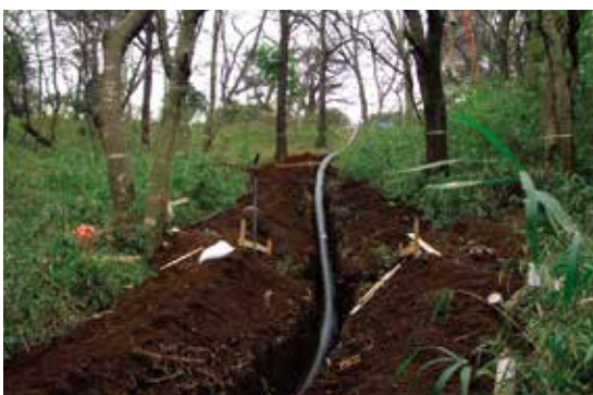
●下水道斜面配管●
