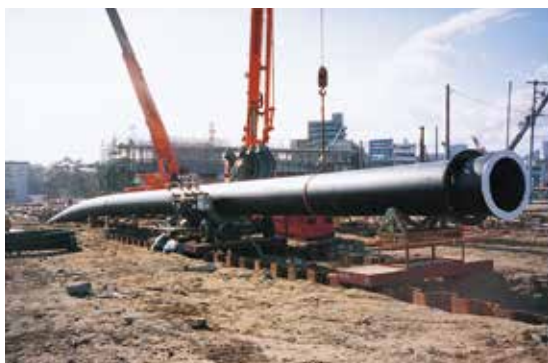
●海水取水冷却配管●
